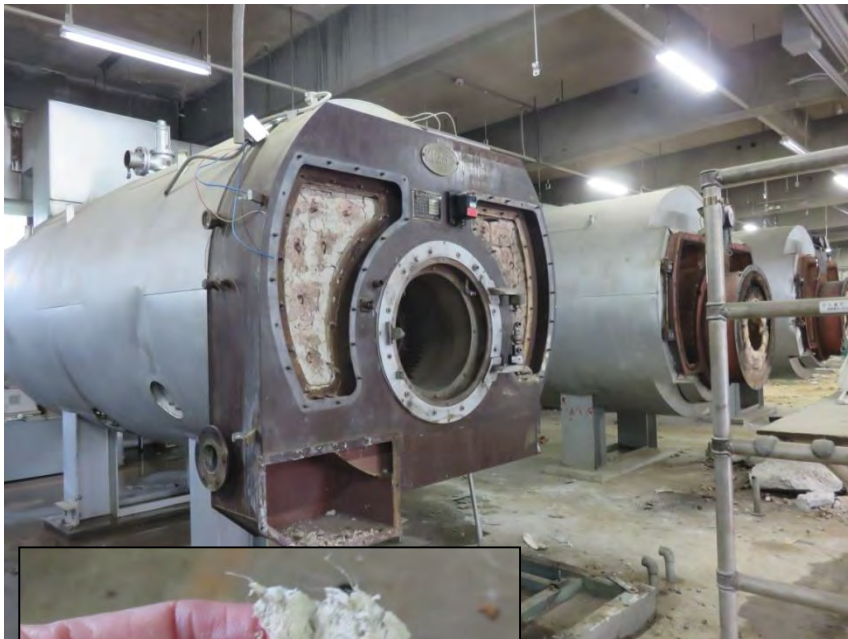
ボイラー周辺保温材
