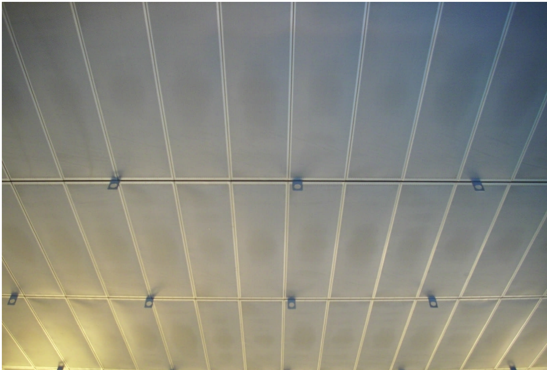
交野・枚方(ただし、津田南迄) に設置された裏面吸音板
