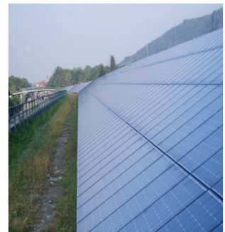
高速道路 821 出力 336KWp 太陽光共同発電所
